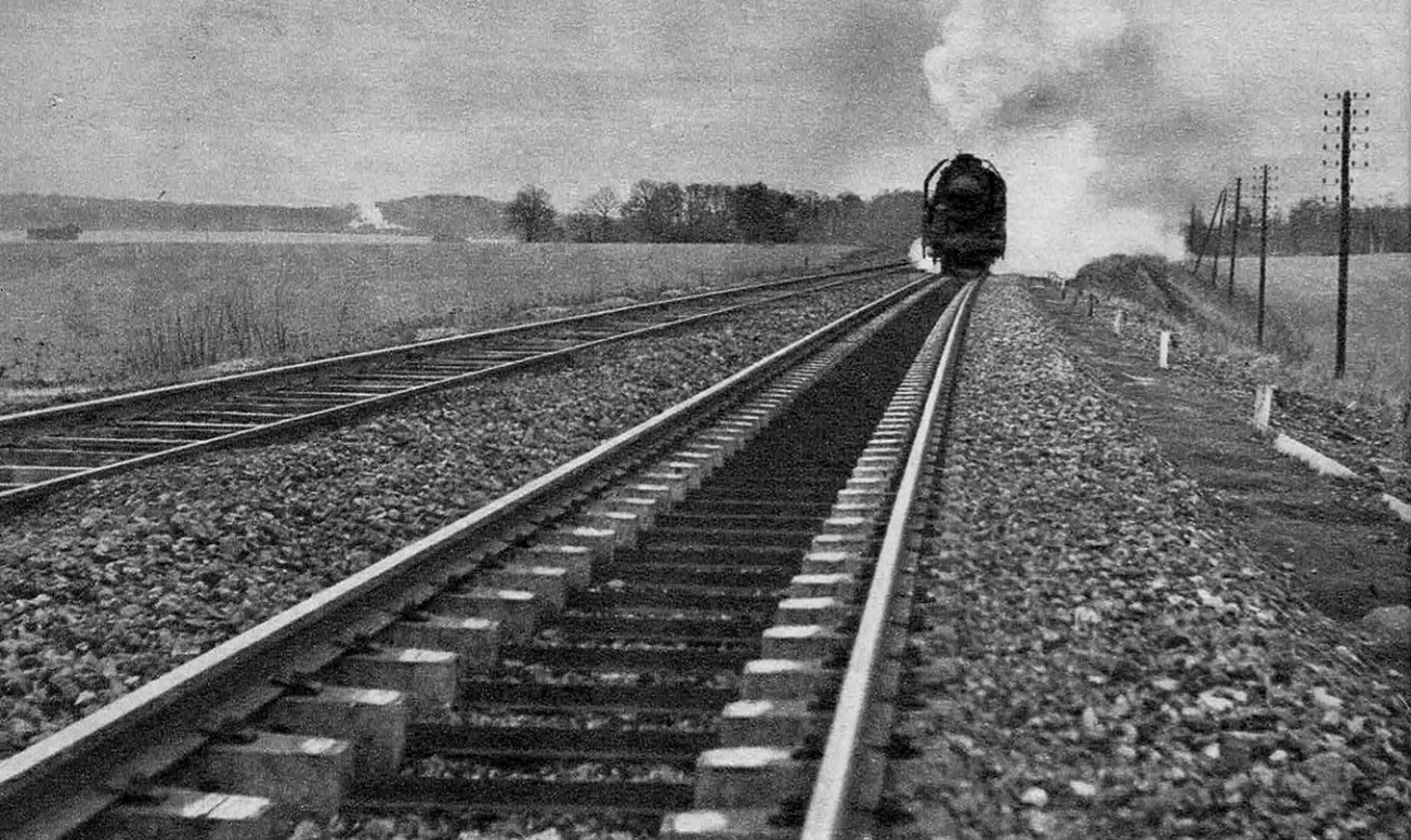
RAILS SOUDÉS DE 700 M SUR TRAVERSES « R. S. », DE LA LIGNE CHARBONNIÈRE DU NORD
