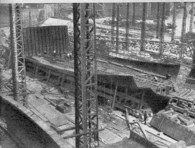
Montage des varangues (tôles verticales) de ballast et d'une cloison transversale sur un grand chalutier.
