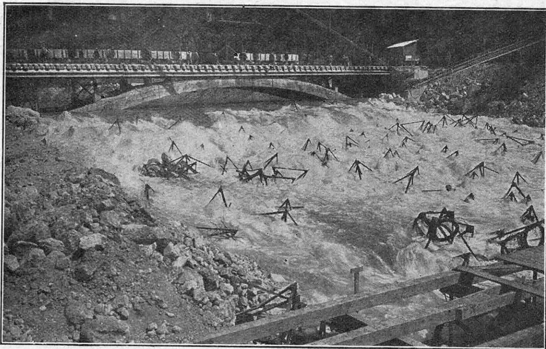
FIG. 6. — LE « PONT DE SERVICE » AMONT AVANT LE DÉBUT DES TRAVAUX DE COUPURE On a encombré le fleuve de « tétraèdres » métalliques. Ces formes géométriques s'accrochent entre elles ou, encore, aux aspérités du lit, sans trop gêner l'écoulement. Là-dessus, on pourra commencer la déjection des premiers matériaux qui assureront la coupure du fleuve.
