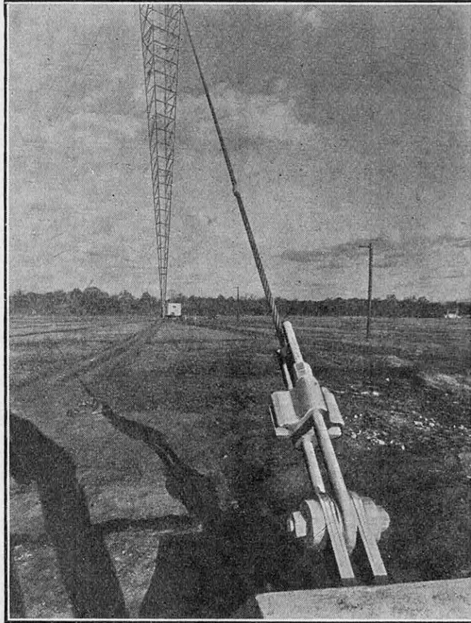
FIG. 4. — DISPOSITIF D'ANCRAGE ET DE TENSION D'UN DES HUIT HAUBANS MAINTENANT L'ANTENNE CONSTITUÉE PAR UN PYLONE RAYONNANT DE 267 MÈTRES DE HAUT DE LA STATION DE NASHVILLE (TENNESSEE, ÉTATS-UNIS)
