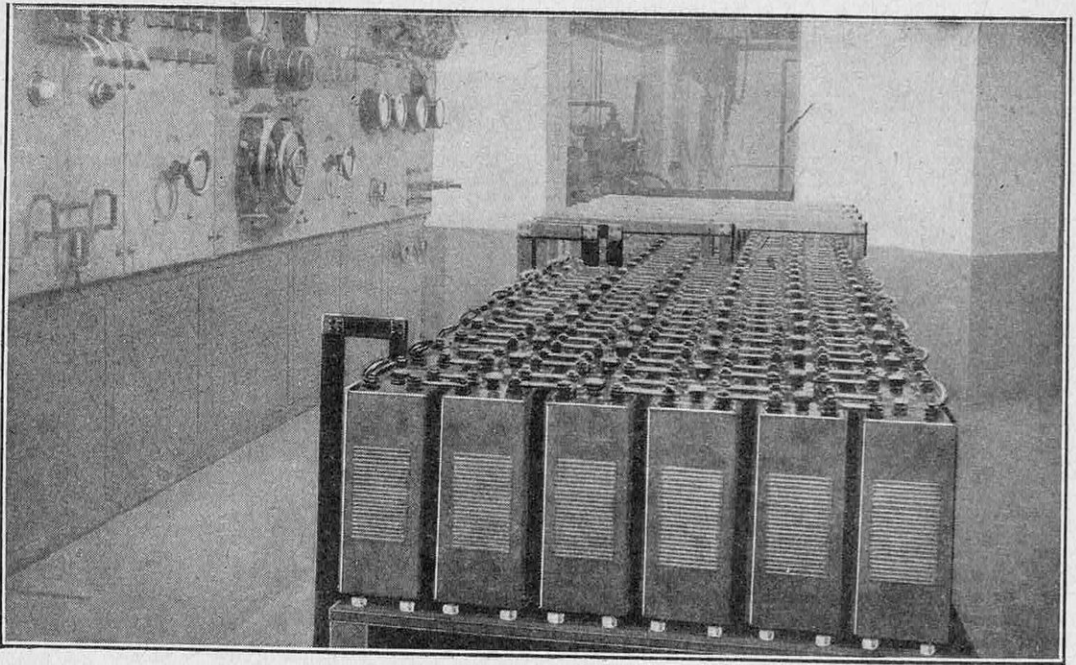
FIG. 1. — BATTERIE D'ACCUMULATEURS DE SECOURS « S. A. F. T. », AU FER-NICKEL, INSTALLÉE A LA BANQUE DE L'INDOCHINE, A PARIS, ET COMPRENANT 100 ÉLÉMENTS DE 400 AMPÈRES-HEURE
