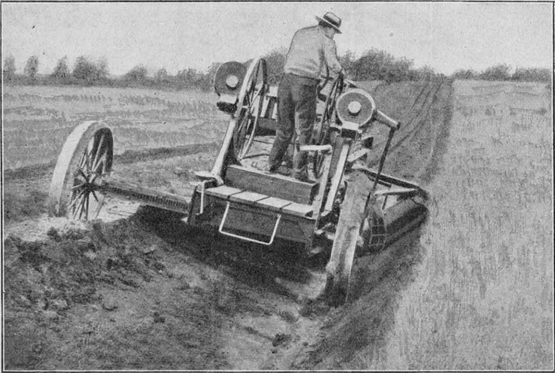
MACHINE AMÉRICAINE PERMETTANT L'EXÉCUTION RAPIDE DES FOSSÉS DESTINÉS A L'ÉCOULEMENT DES EAUX OU DE RIGOLES LONGITUDINALES DANS LES FONDATIONS DE CHAUSSÉES NOUVELLES, POUR EN ASSURER LA CONSERVATION
